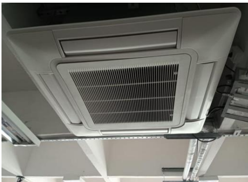
Figura 41 - Instalação de aparelhos de ares condicionados nas Salas de aula Bloco J – 3º andar
